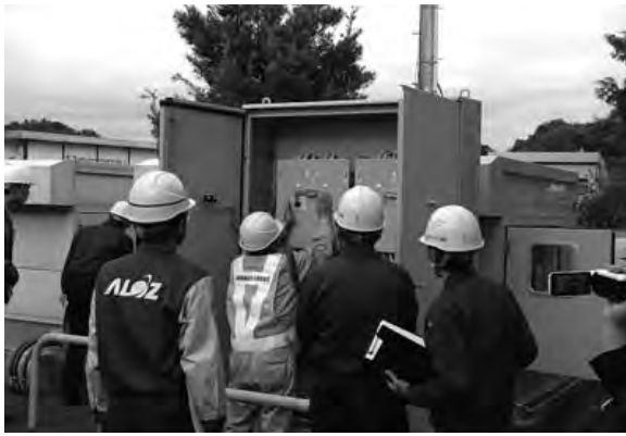
非常用電源の稼働を確認
